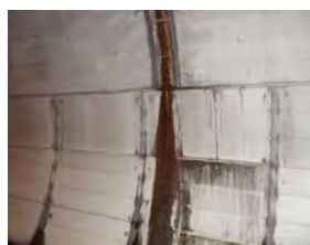
小規模な損傷
