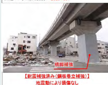
国道45号(観測震度: 震度6弱)
